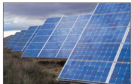
CENTRAL DE PLACAS SOLARES
